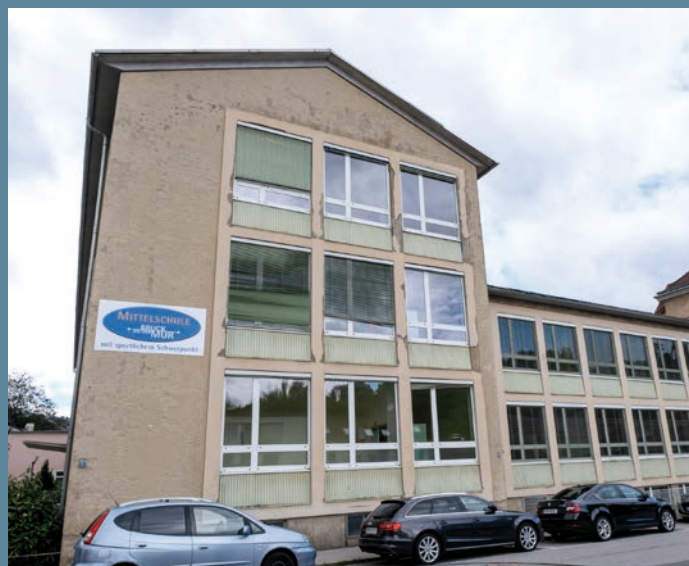
Auch der Zubau aus dem Jahr 1956 ist mittlerweile stark in die Jahre gekommen.
